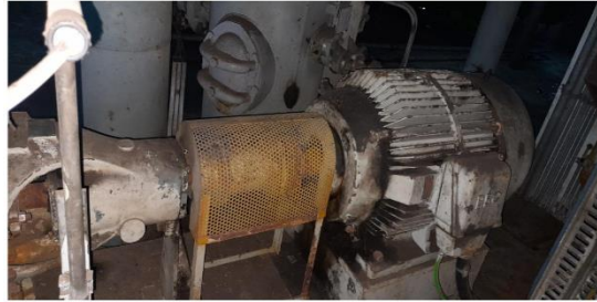
شكل رقم (3) مضخة مياه الخدمة
