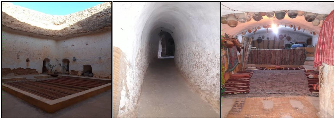
صور (11) توضح الفناء ومداخل الغرف والفتحات المستخدمة للتهوية من الفناء بمسكن الحفر غريان [17]
